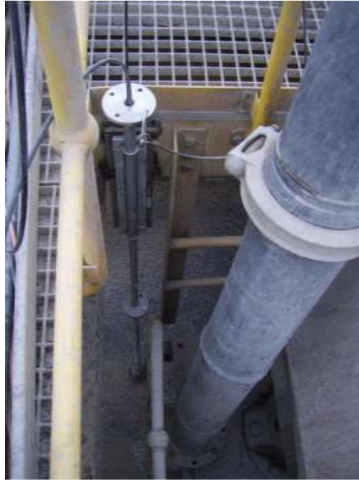
Figura 31: Montaje del soporte de la sonda del filtro de Cynoprobe v2 bien asegurada al borde del tanque
